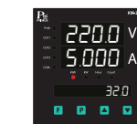
แสดงค่า Volt, Current, kWh
