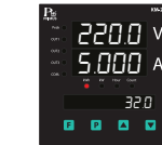
แสดงค่า Volt, Current, kWh
